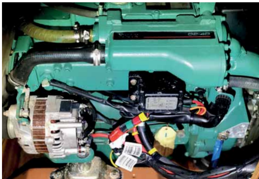
Nejčastějším zdrojem elektrické energie na lodi je alternátor, který je součástí motoru, pokud tedy není loď vybavena samostatným generátorem.
